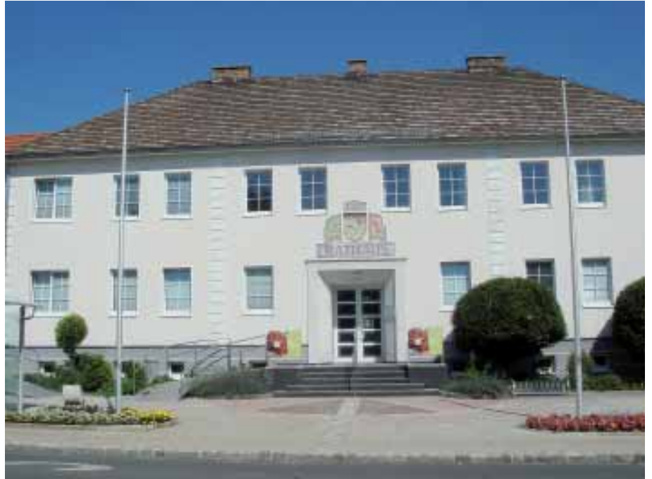
Das Wiesener Rathaus - nach 50 Jahren ist Dach renovierungsbedürftig
